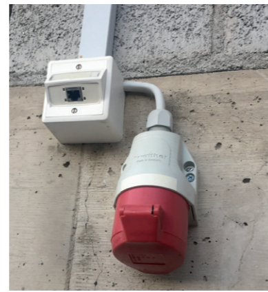
Abb. 50: Vorrichtung für eine spätere Ladestation mit CEE-Stecker und LAN-Verbindung. Optimale Lösung für die Einfügung der Ladestation in ein Lademanagement- und/oder Zutritts- und Bezahlsystem.
