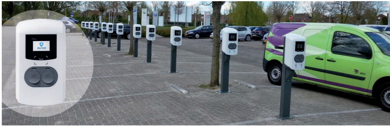
Abb. 23: Betriebsparkplätze für Mitarbeiter (Alfen Eve Double Pro-line Ladestation).
