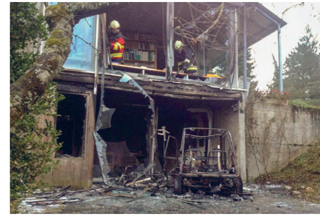
Abb. 47: Feuer bricht im Bereich der elektrischen Installation des eFahrzeuges in der Garage aus. Elektrische Widerstände führen zu einer lokalen Aufheizung der Kabelverzweigungen, einem Isolationsdefekt und verursachen schliesslich den Brand.
