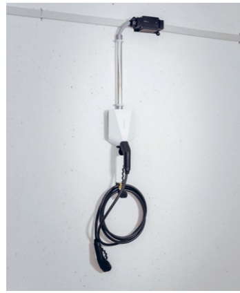
Abb. 80: Easee Station ab Flachbandkabel mit verriegeltem Ladekabel (Quelle: ewz).
