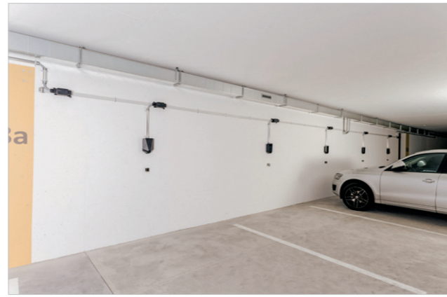
Abb. 54: Skalierbare Installation in einer Tiefgarage mit easee Stationen basierend auf Rückplatten (Quelle: ewz).
